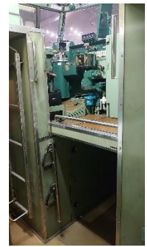
▲運転室の様子
